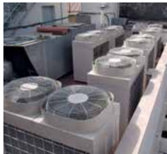
Hotel Dimar, Valencia Sistema de caudal variable
