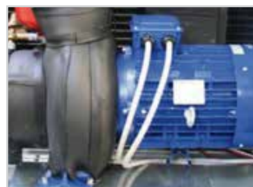
Bomba de agua de caudal variable.
