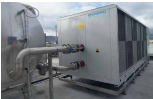
Gascon Vermuyten, Vitoria (Álava) Enfriadora aire-agua compresor tornillo. Potencia instalada 541 kW. Proceso industrial de enfriamiento de la nata.
